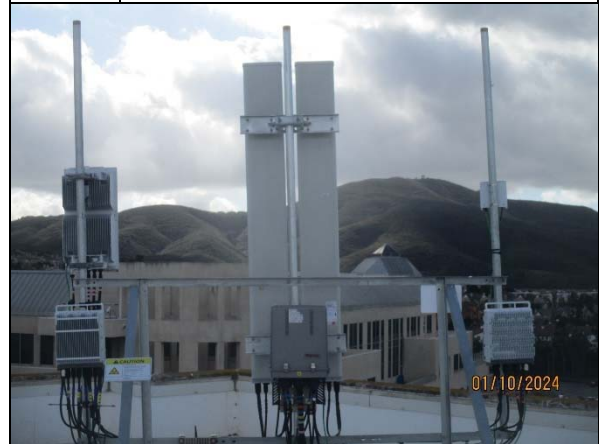
23. Verizon Sector B Antennas
